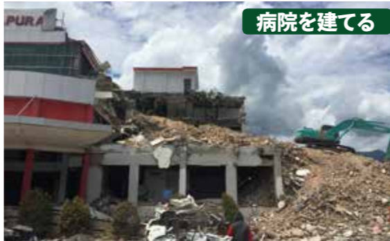
耐震性が不十分であったために地震で一部倒壊したバル市の公立病院。現在は整地されており、再建に向けた計画が進められている。
