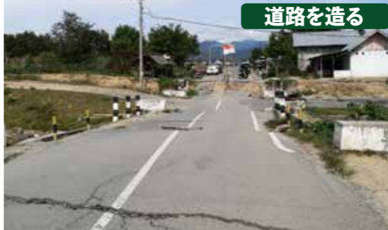
液状化で多くの家屋が流され、道路も寸断された。JICAの支援で整備と舗装を行うことを計画。
