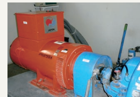
日本の無償資金協力により供与された発電設備
