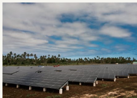
日本が支援してトンガに設置された太陽光発電設備
