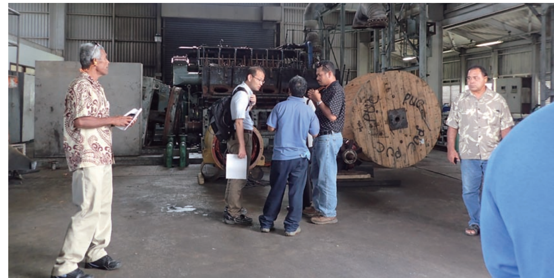
ミクロネシアのボンベイ島で、発電所の運用状況を確認中。発電施設を安定して稼働させ続けることも、電力供給では重要な視点だ
