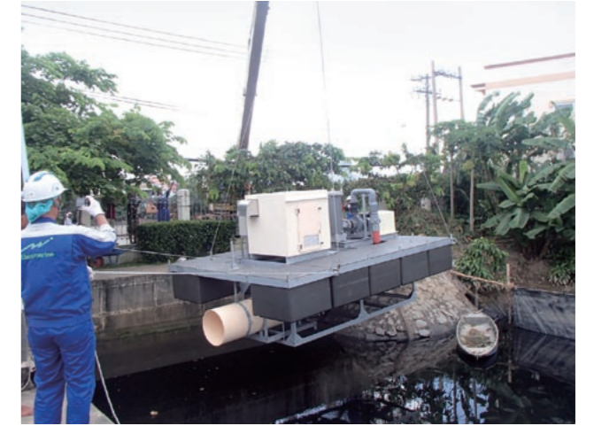
ホーチミンの調整池に設置されたジェットストリーマー。筒状の部分から水流が発生
