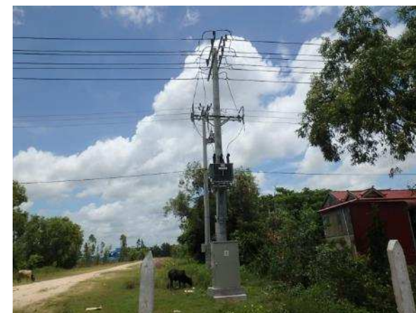
設置した柱上変圧器 (バベット)
