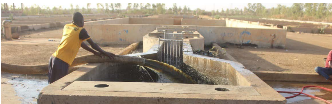
バキュームカーから沈殿槽への汚水の流し込み。
