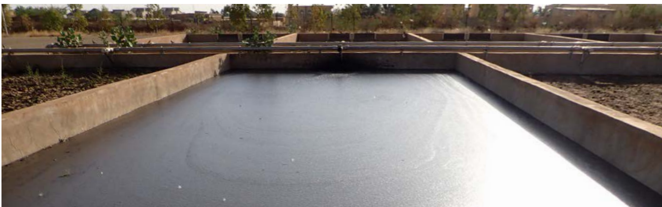
乾燥槽で、天日乾燥される下水汚泥。乾季であれば、1週間ほどで乾燥します。
