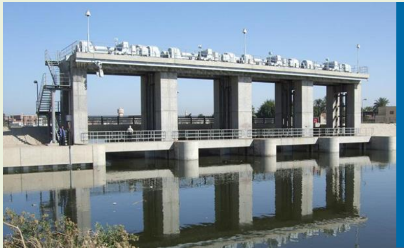
バハル・ヨセフ灌漑用水路ダハブ堰（無償資金協力により2010年改修完了）
