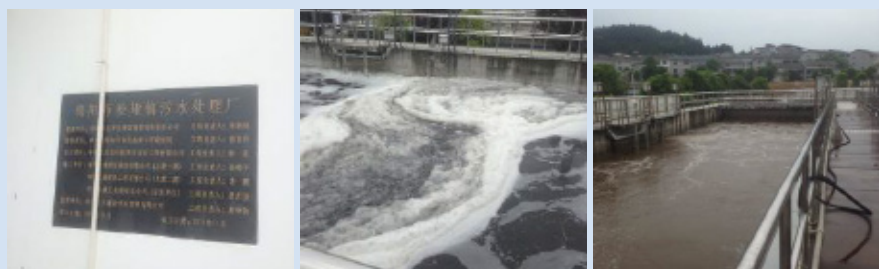
綿陽市松婭鎮 污水处理場
