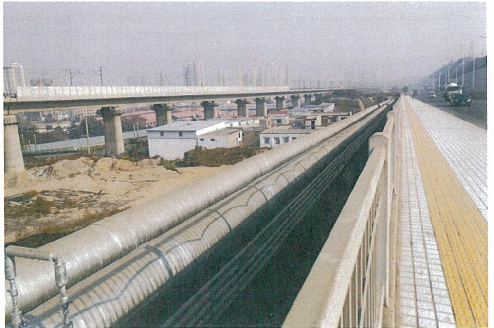
南山路大金沟2xDN1200供热管网架空管
