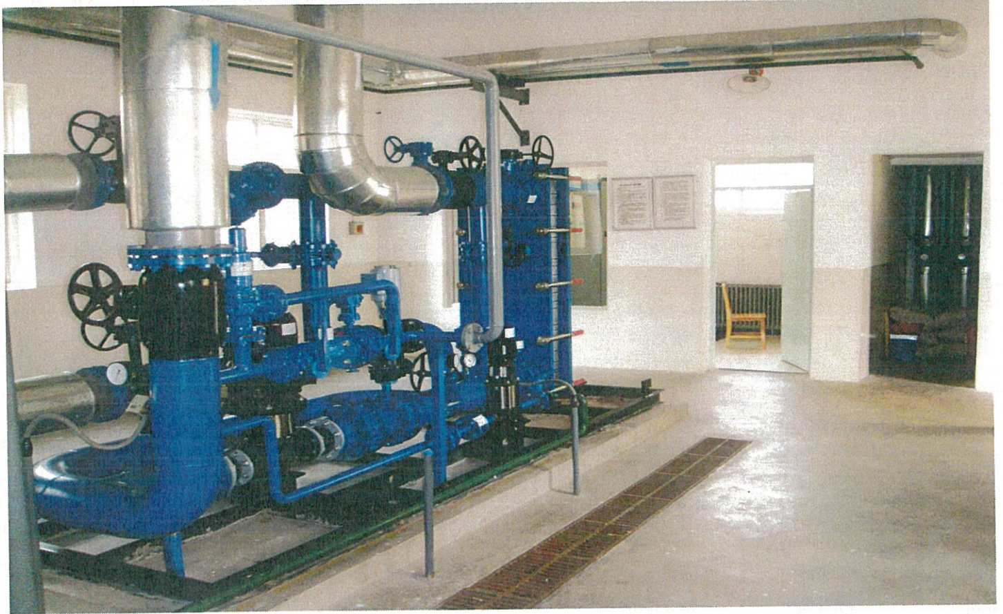
建成后的兰棉厂热力站
