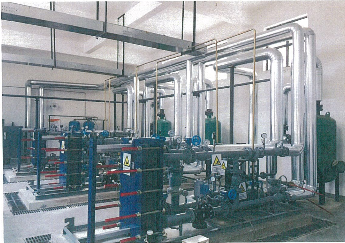
倚能城市之光热力站内景 ( 2015年建成, 4MW )
