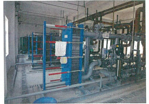
银滩花园热力站内景 ( 2012年建成, 28.5MW )
