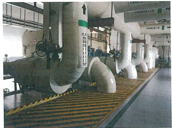
范坪电厂2号首站循环系统
