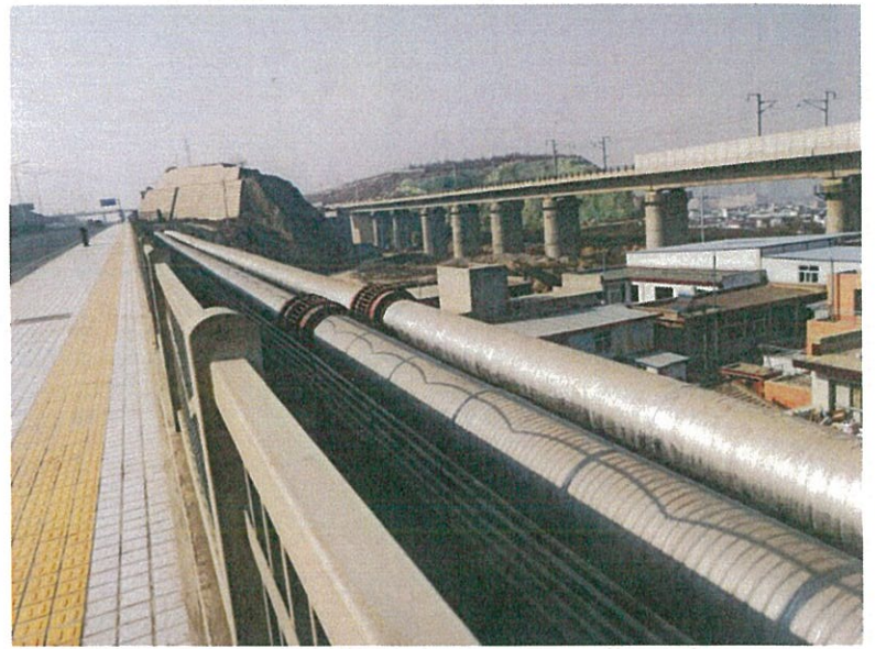
南山路杜家沟2xDN1200供热管网架空管
