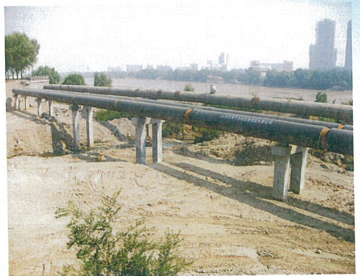
南滨河路大金沟2xDN1200供热管网架空管
