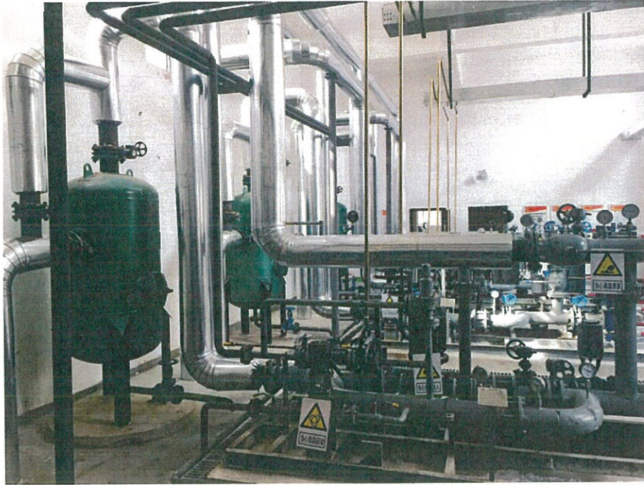
陶瓷市场热力站内景 ( 2015年建成, 10MW )
