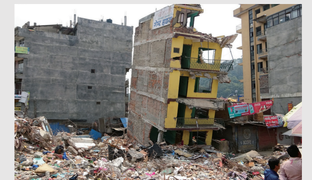
2015年ネパール地震災害の被災状況
